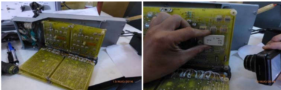
Hình 6. Ảnh chụp khối H001-76 nhìn từ bên ngoài - hỏng biến áp
