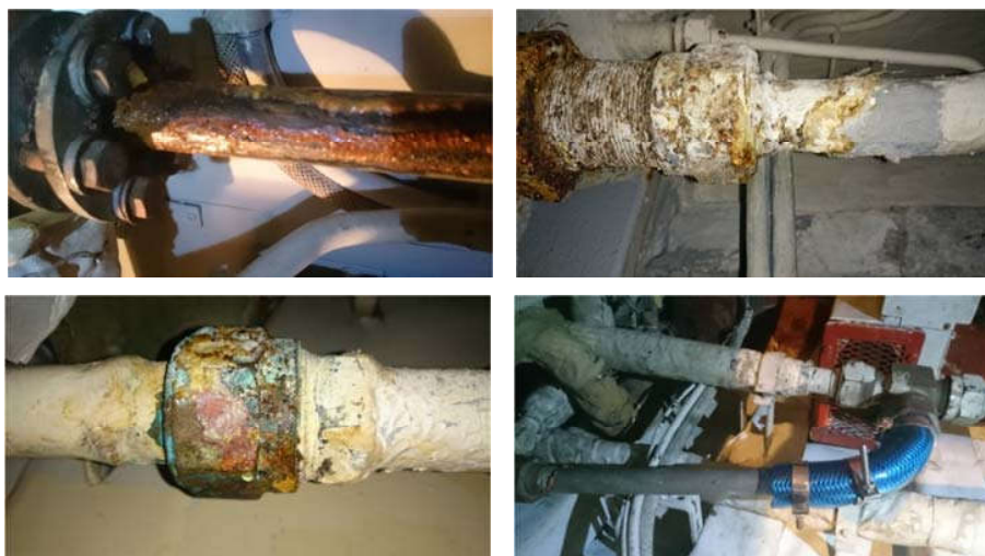
Hình 5. Hư hỏng các đường ống, đầu nối ren đường ống làm mát
