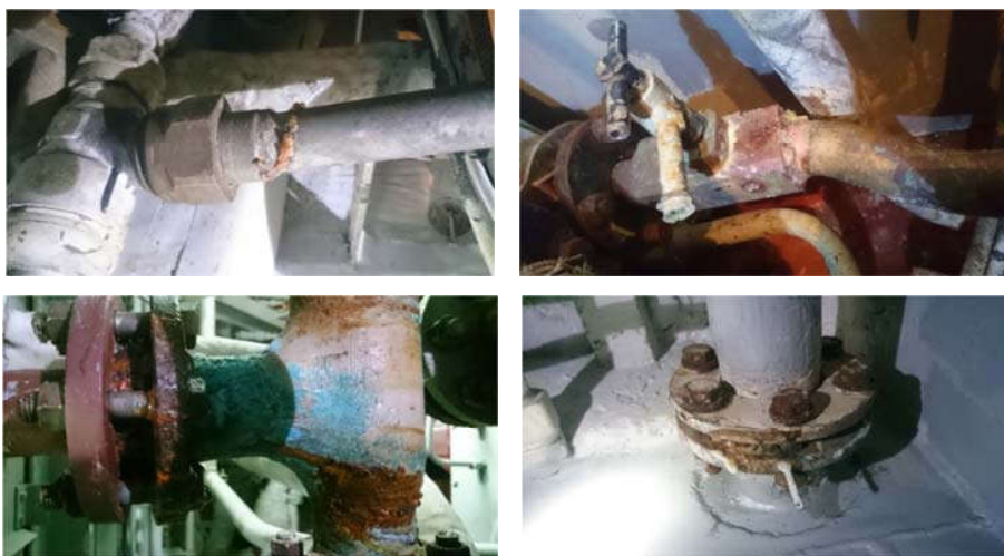
Hình 6. Hư hỏng các mặt bích đường ống làm mát trên tàu
