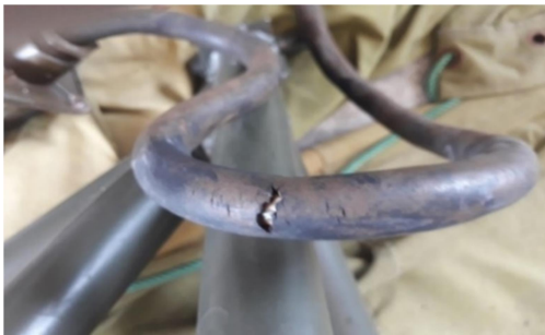
Vỏ cáp bị nứt vỡ
